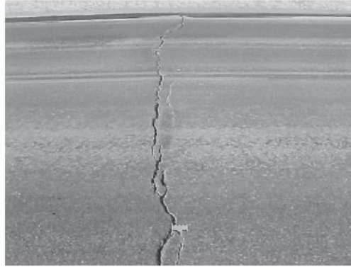
Figure 5: Thermal cracking (Subramani, 2022)
